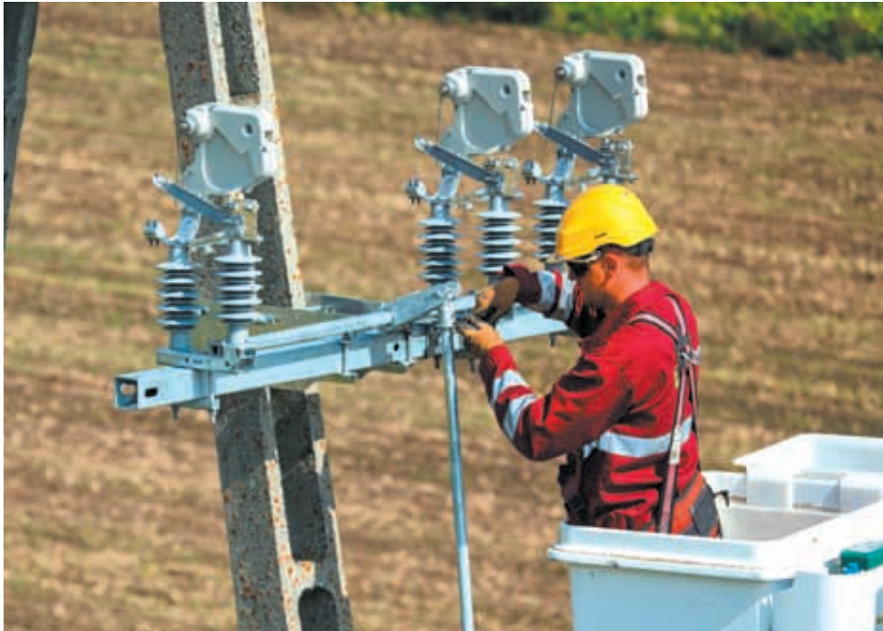
W 2014 roku prace na liniach niskiego napięcia wykonywane były w zdecydowanej większości (90%) bez konieczności wyłączenia zasilania
