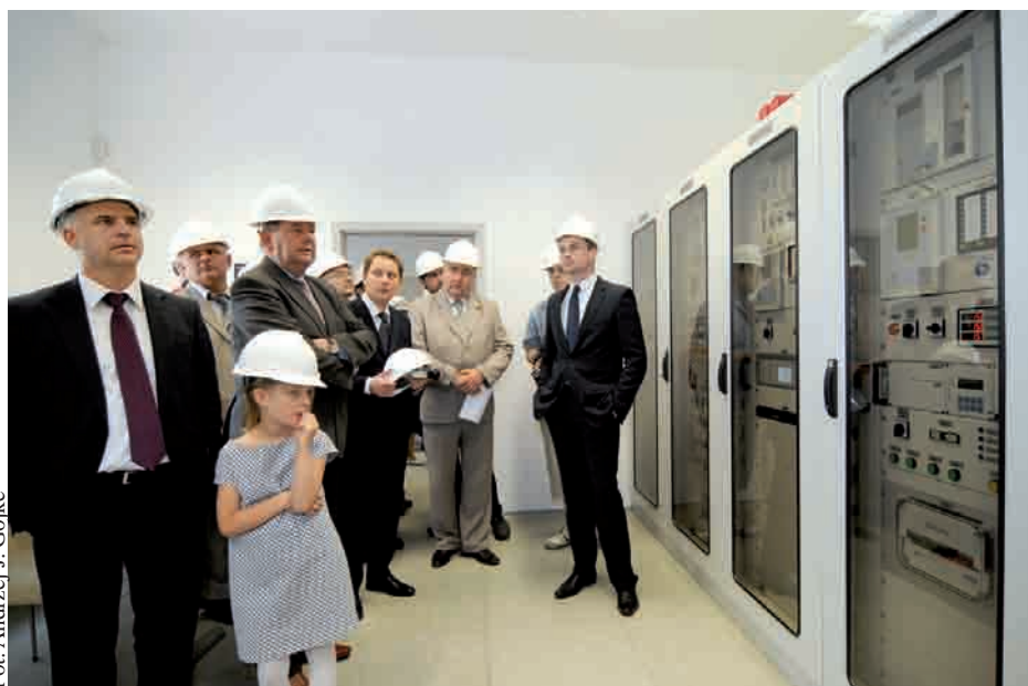
GPZ Nowy Port wyposażono w rozdzielnicę typu Highly Integrated Switchgear
